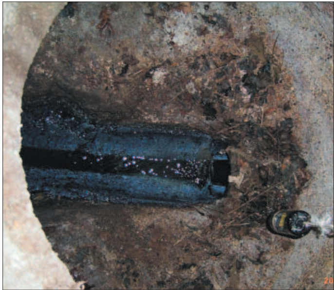
Brønd med logger og tæringer
