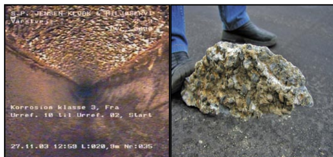
Billede 1: Eksempel på korrosion i øvre del af kloakrør samt rørskal fra toppen af en korroderet Ø400 betonledning.
