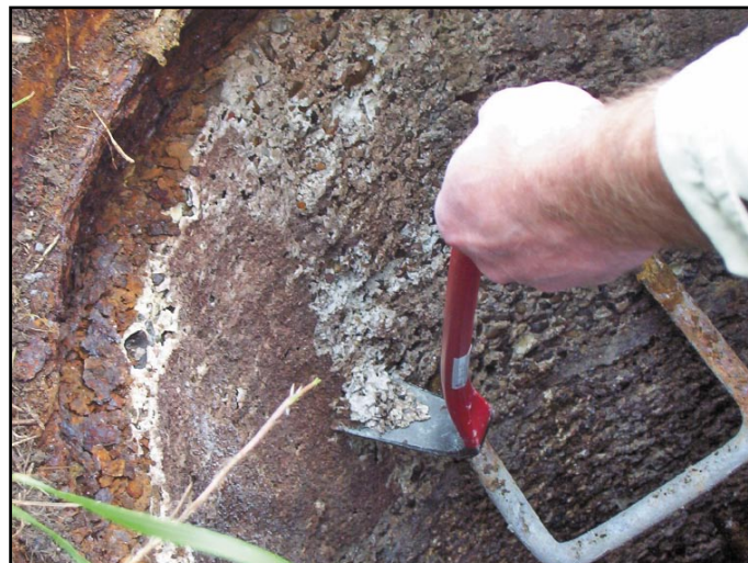
Billede 2: Korrosion i betonbrønd
